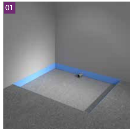
Afb. 1: Het WESKO Ambiente douche-element wordt geplaatst in de uitsnijding van de dekvloer.
